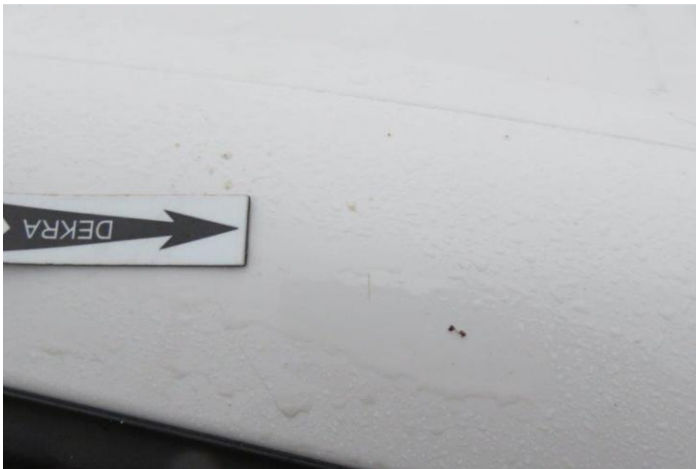
Fot. 49. rama lewa dachu
