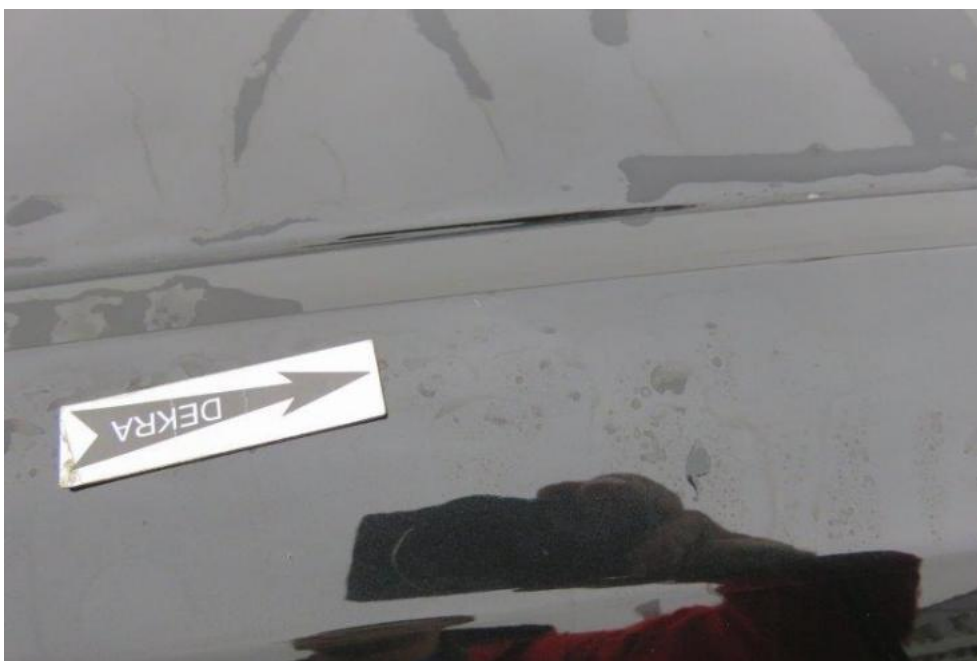
Fot. 70. rama prawa dachu
