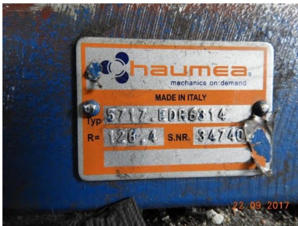
Fot. 10. tab. przekładni
